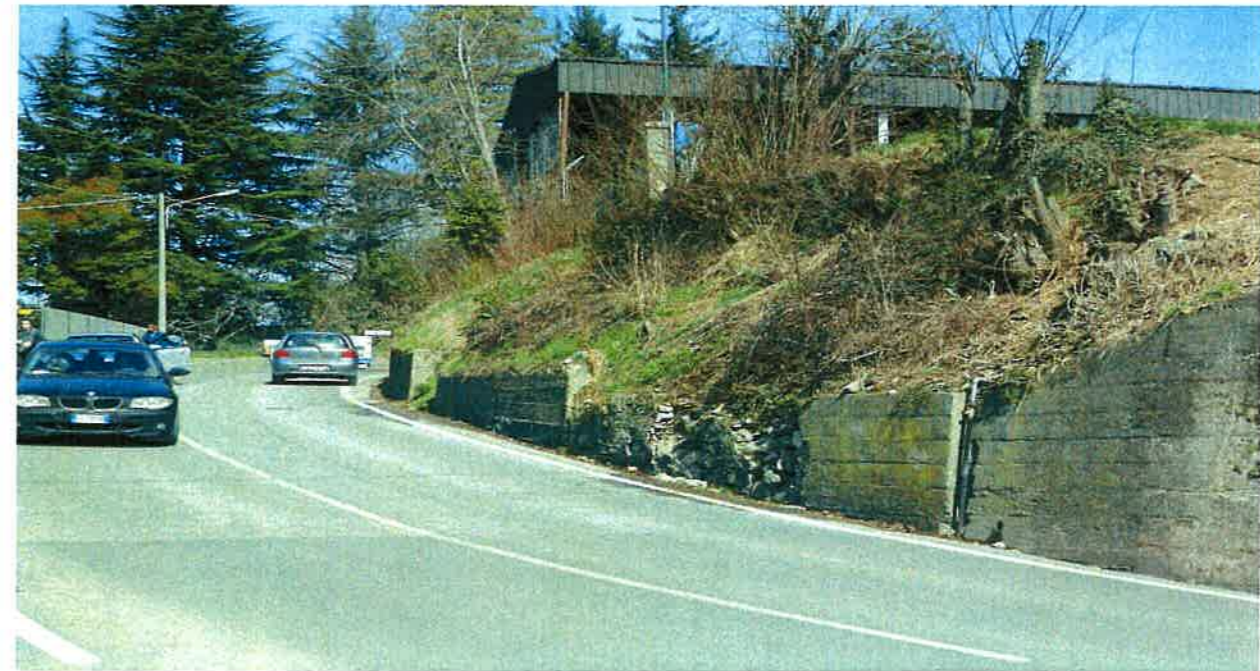
2. Vista della parte degradata del muro di contenimento Via Adua.
